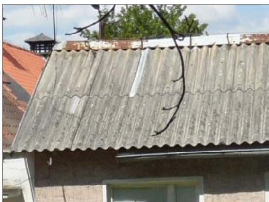
Fot.1 Płyty azbestowo-cementowe faliste
